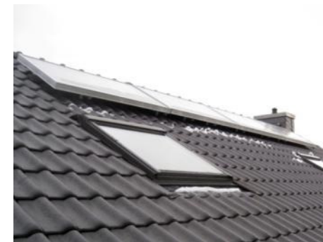
Solaranlage für Heizung und WWB
